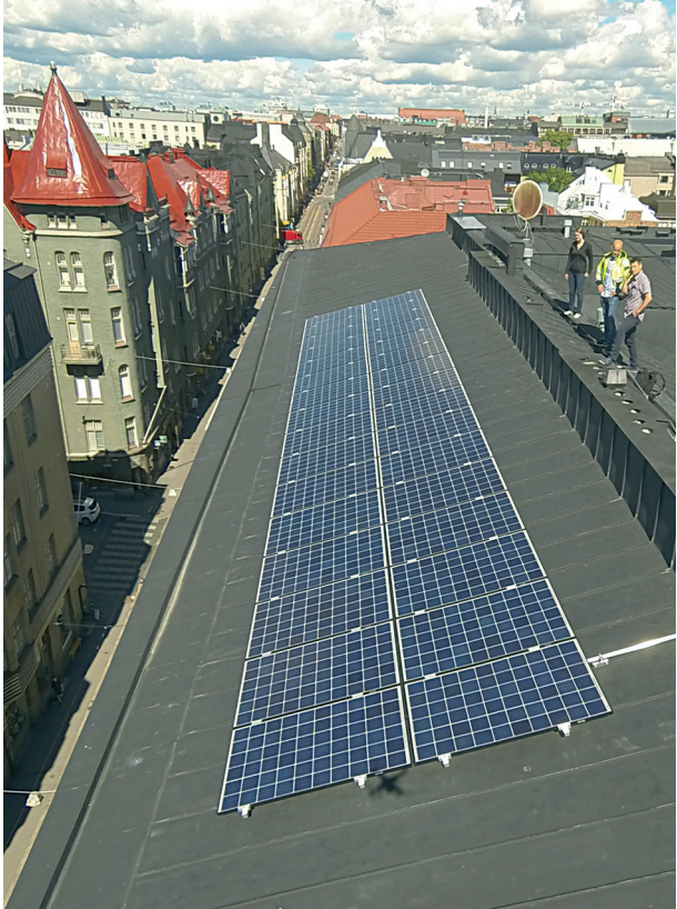
Fredrikinkatu 25:n aurinkovoimala. Kuva: Janne Käpylehto
